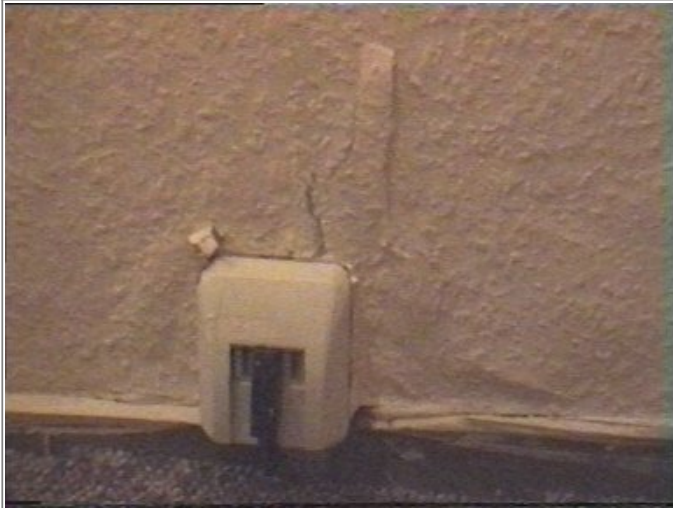
Die Telefondose war komplett von der Wand abgesprengt worden und lag auf der gegenüberliegenden Flurseite.
